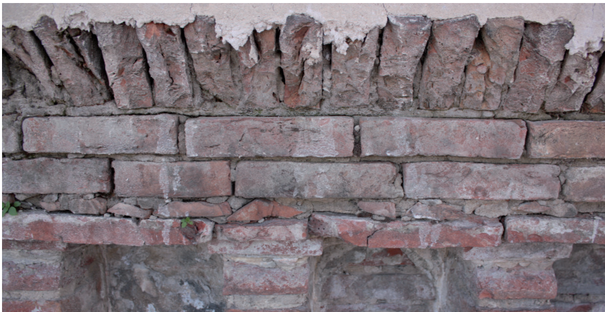
Cornicione sconnesso, messo in sicurezza
