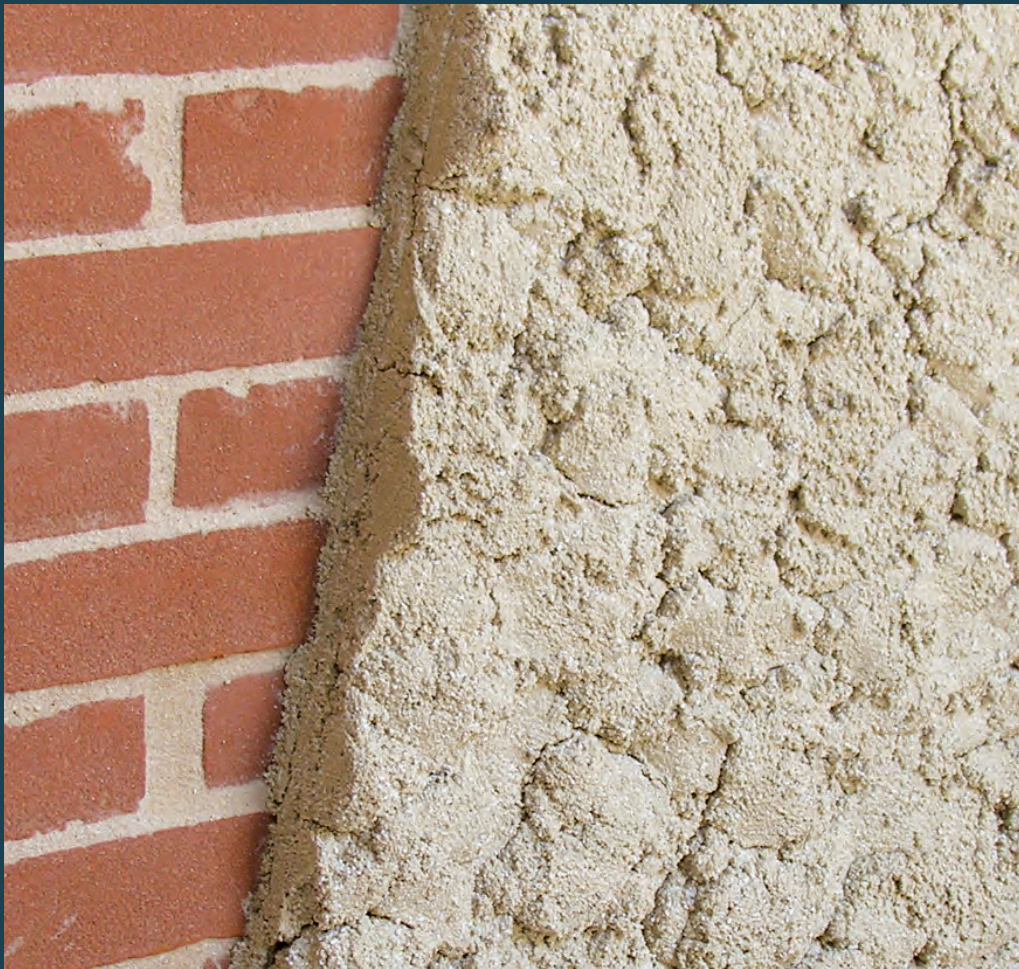
Tampone estrattore dei sali (dettaglio)
