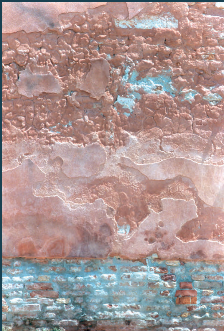
Efflorescenze saline che cristallizzano in superficie.
