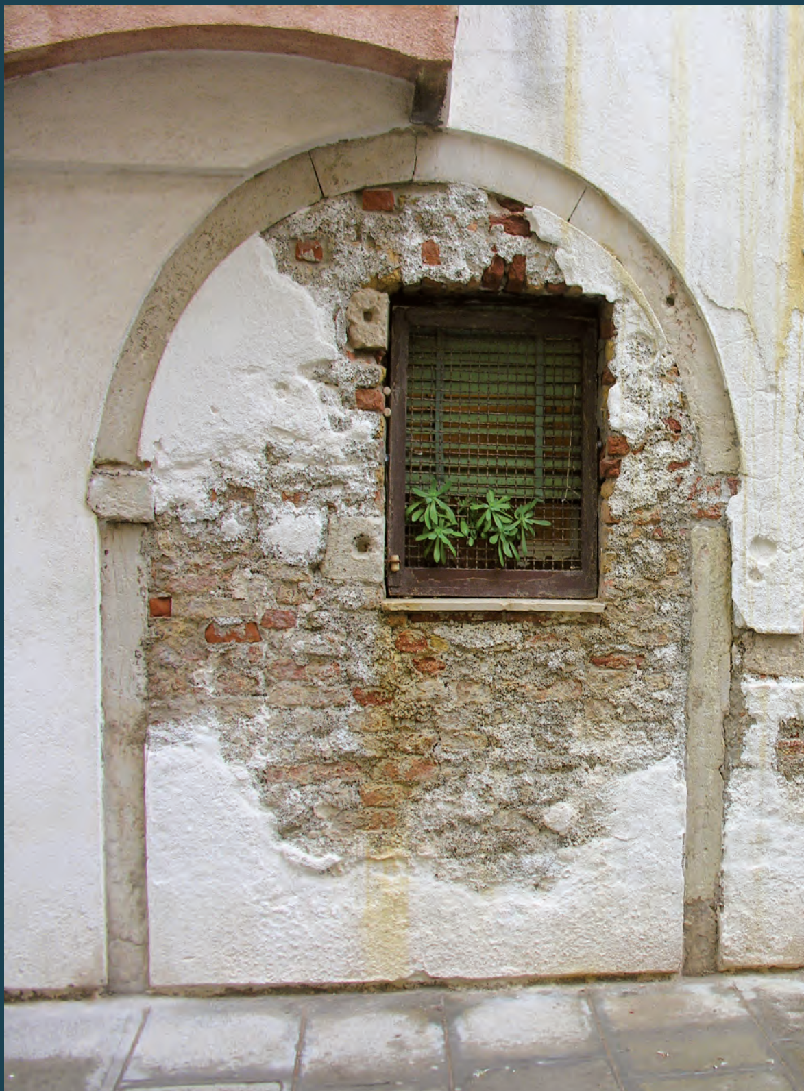
I sali che cristallizzano distruggono l'intonaco sull'area di bagnasciuga.
